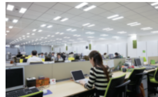
人感センサー付きのLED天井照明システム。
