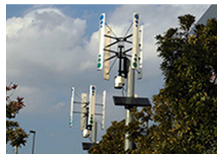
首都圏IDCに設置されているハイブリッド街灯
