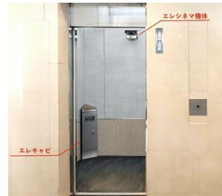
エレベーターに設置された「エレキャビ」と「エレシネマ」
