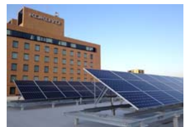
大阪新館オフィスに設置されている太陽光パネル
