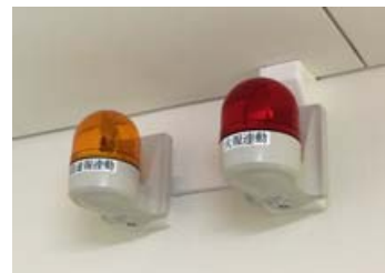
オフィス、トイレ各所に地震、火災、時報を知らせるパトライトを設置
