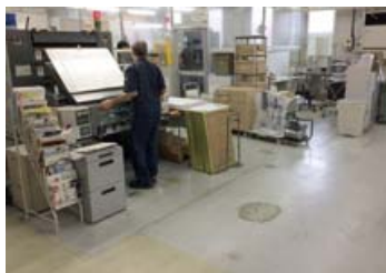
リニューアル前)工場の床面は塗装が一部剥げててこぼこ
