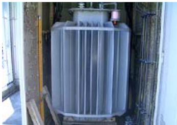
解体前の変圧器
