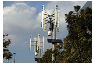
首都圏IDCに設置されているハイブリッド街灯
