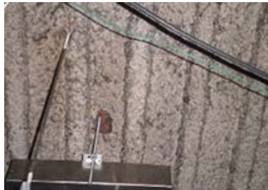
天井開口部から見たアスベスト
