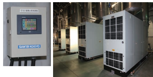
4台のインバータ式コンプレッサーと、それらをコントロールする制御装置。運転台数を絞ることで、0~148kWまで出力を変えて自動運転する。
