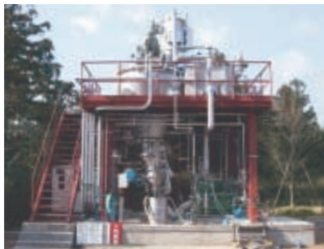
コクヨ孤野配送センター内に設置されたリグニン製造プラント。
